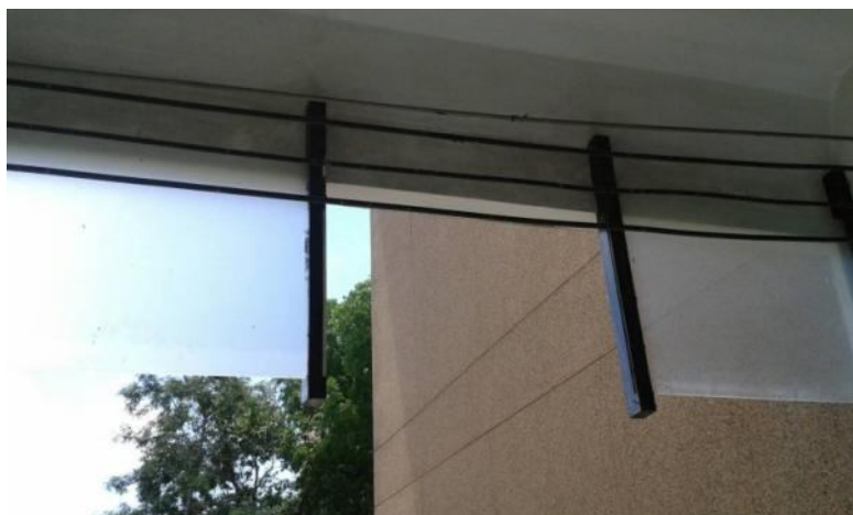
เปลี่ยนกระจกที่แตกบริเวณ ชั้น ๑
