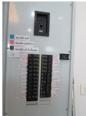
ติดสัญลักษณ์สี ณ ตู้ควบคุมไฟ
